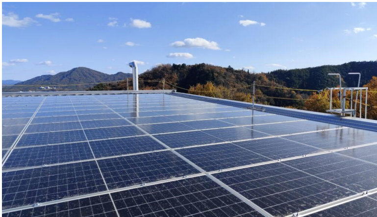
設置した太陽光パネルの様子
